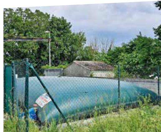
Bâche incendie village de La Coindrie
